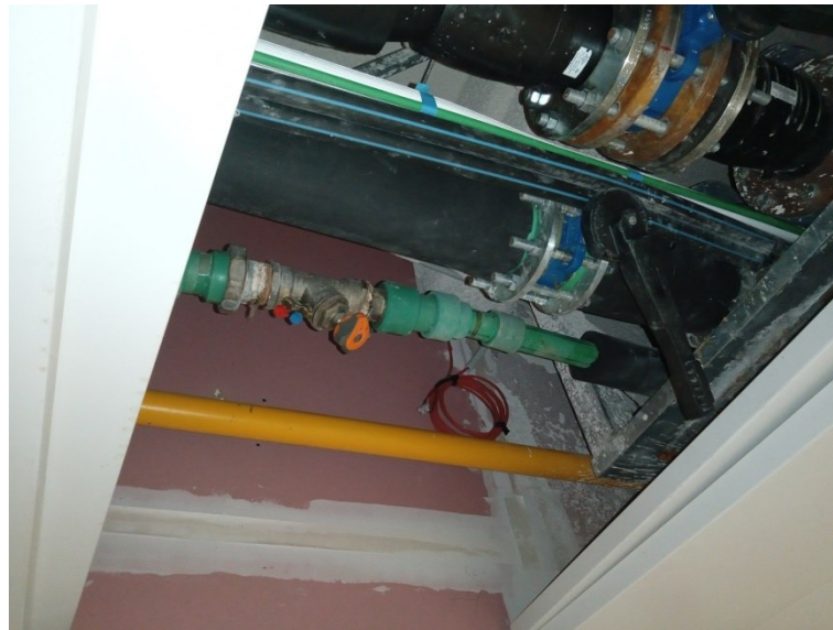
Fig. 16. Situación actual de acceso al forjado técnico (falso techo) de las salas clasificadas.
