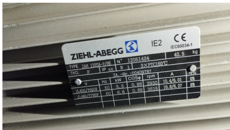
Fig. 7. Placa de características equipo motoventilador Climatizador I.
