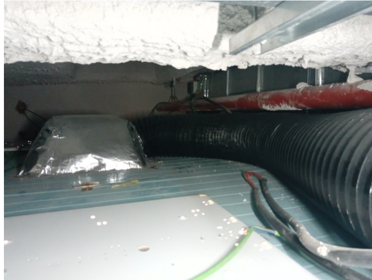
Fig. 14. Situación actual del forjado técnico (falso techo) de las salas clasificadas.
