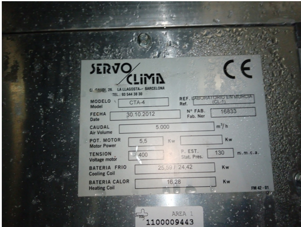
Fig. 2. Placa de características de Climatizador I.
