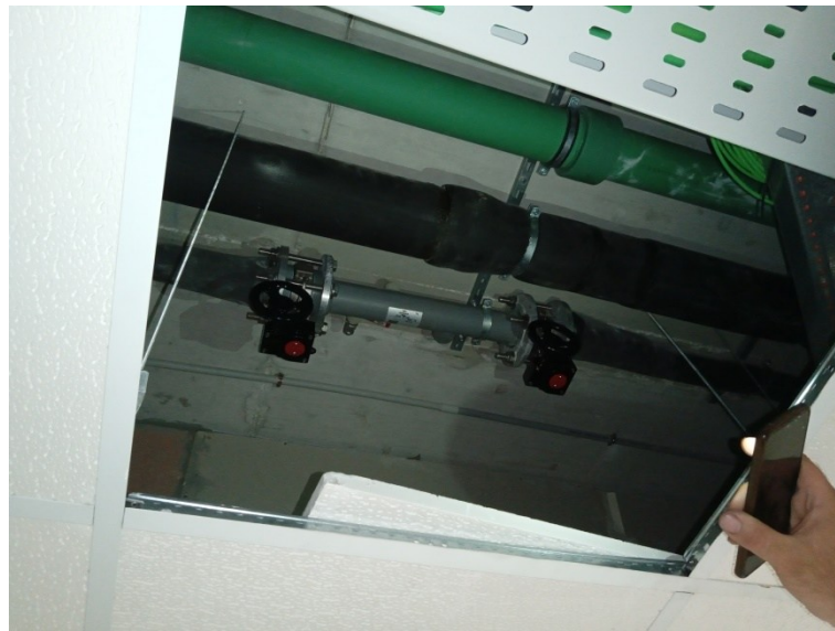
Fig. 17. Situación actual de acceso al forjado técnico (falso techo) de las salas clasificadas.
