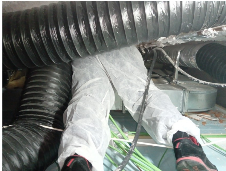
Fig. 15. Situación actual del forjado técnico (falso techo) de las salas clasificadas.
