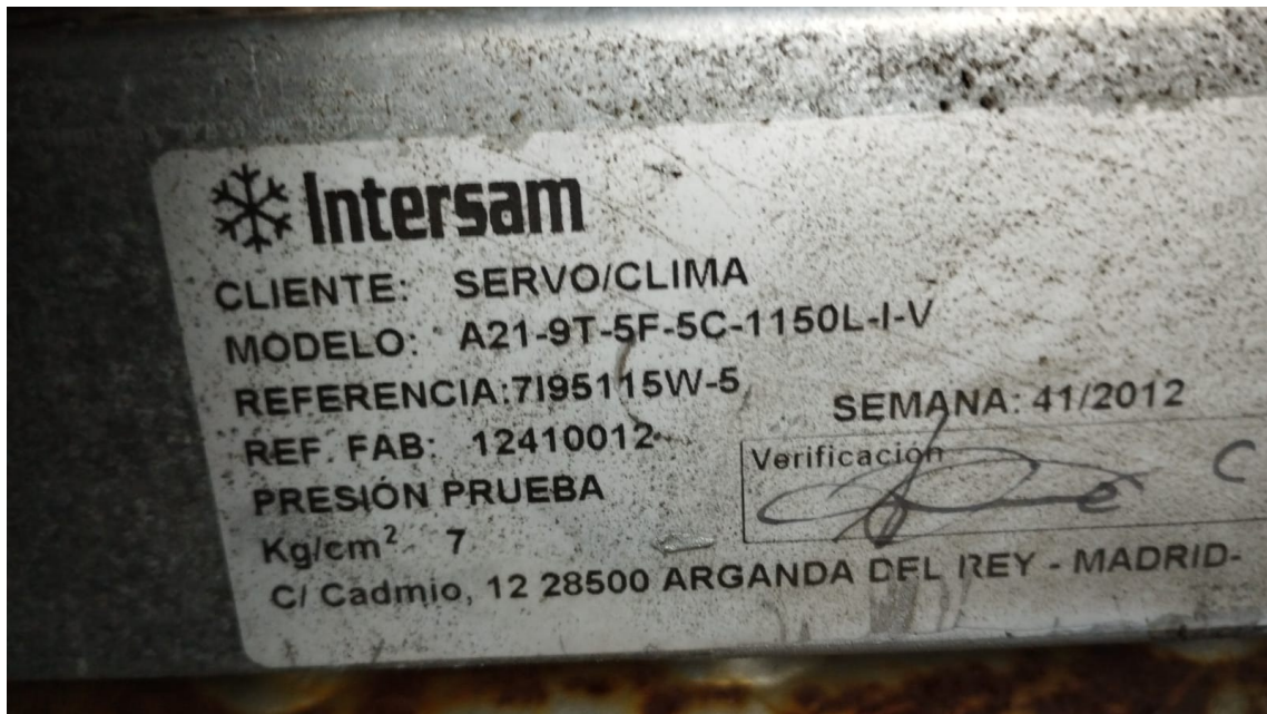
Fig. 3. Placa de características primera batería de Climatizador I.
