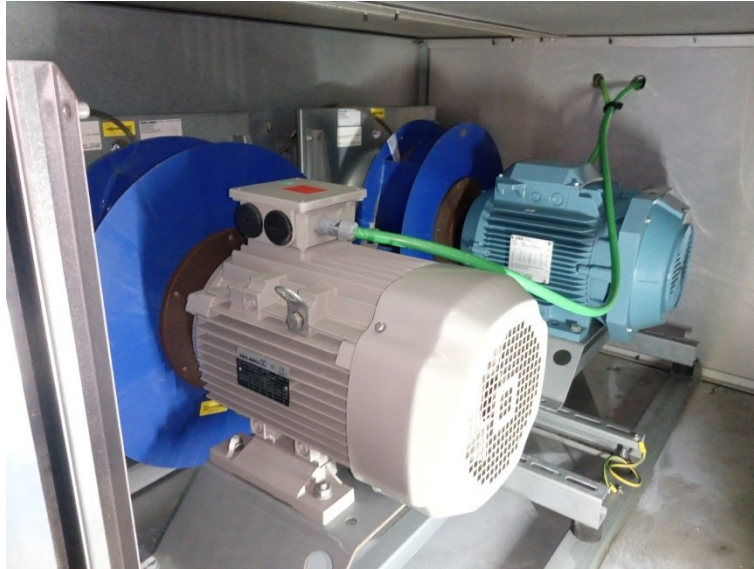
Fig.4. Equipos motoventiladores de climatizador I.
